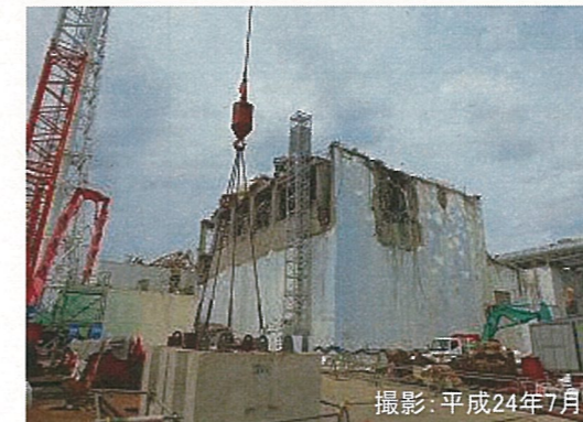
ガレキ撤去後
