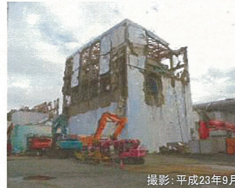
ガレキ撤去前
