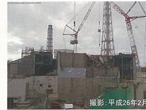
ガレキ撤去後
