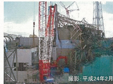
ガレキ撤去前
