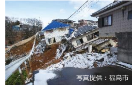
家屋被害：福島市
