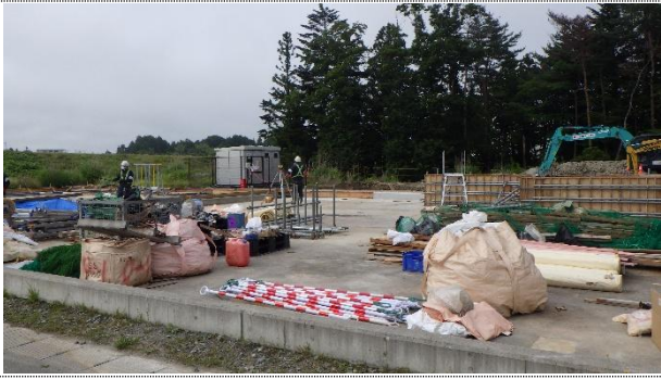
浸出水処理施設
