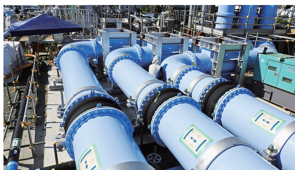
ALPS 処理水希釈放出設備 希釈用海水配管
