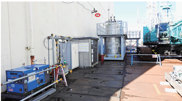
放射性物質を含む水が漏えいした箇所 (写真の赤い丸が水が漏えいした配管)
