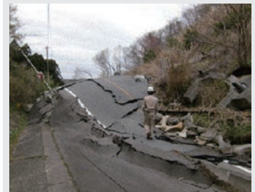
余震による県道の隆起（いわき市渡辺町）
