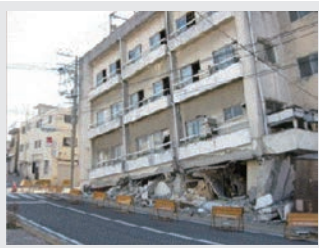
県道沿線の建物倒壊（郡山市麓山地区内）
