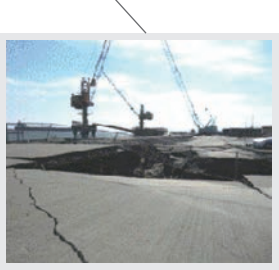
被災した小名浜港7号ふ頭（いわき市小名浜）
