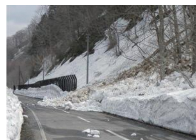
雪崩危険箇所 (国道352号 檜枝岐村)
