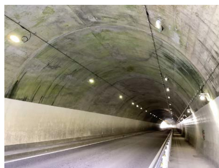
トンネル照明のLED化
