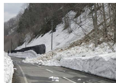
雪崩危険箇所 (国道352号 檜枝岐村)
