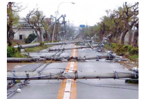
台風で倒壊した電柱（出典：国土交通省）
