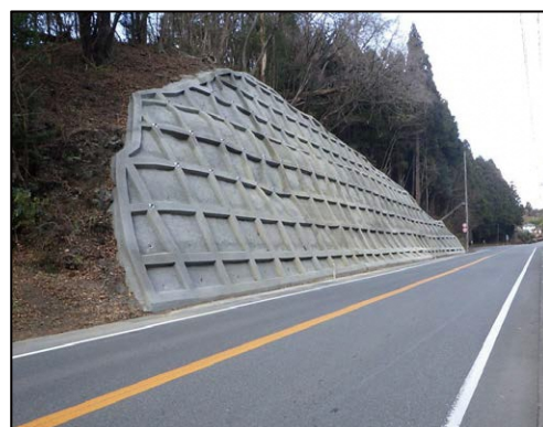
法面保護工箇所 (いわき上三坂小野線 島廻工区 いわき市)
