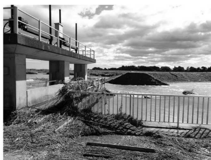
排水機場被害（相馬市）
