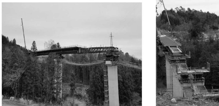
架設工事（送り出し工法）の施工写真 （桁を写真左側から右側へ送り出している状況）
