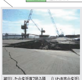
被災した小名浜港7号3頭（いわき市小名浜）
