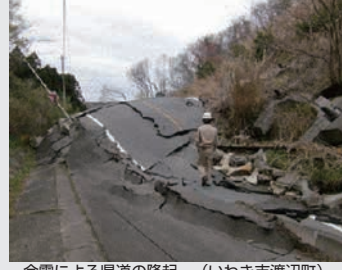
余震による県道の隆起（いわき市渡辺町）
