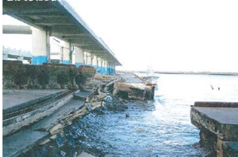
被災状況(岸壁崩壊)
