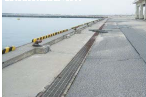
被災状況(岸壁背後の沈下)
