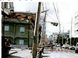
阪神淡路大震災で倒壊した電柱 (出典：国土交通省)
