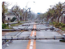
台風で倒壊した電柱 (出典：国土交通省)
