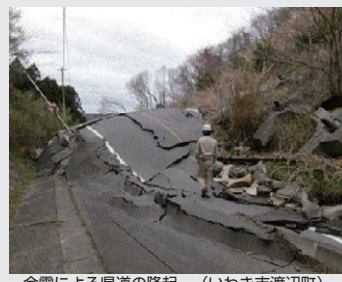
余震による県道の隆起（いわき市渡辺町）
