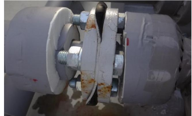
漏水が発生した配管フランジ部分
