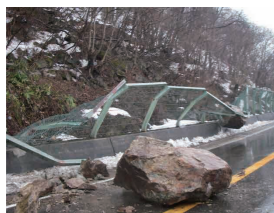
国道121号の通行止めにより、地元の物流業界や地域住民の交通に大きな影響が出ました。
