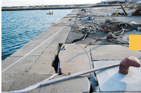
四倉漁港(被災状況)
