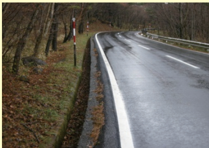
路肩がせまく走りづらい道路
