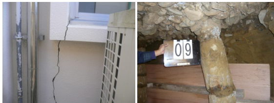
写真 1: 外壁のクラック
