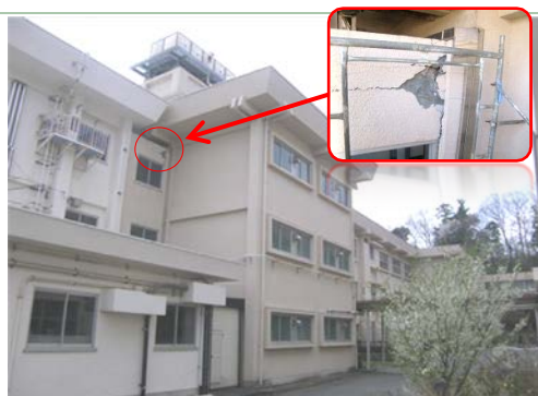
外壁の被害状況
