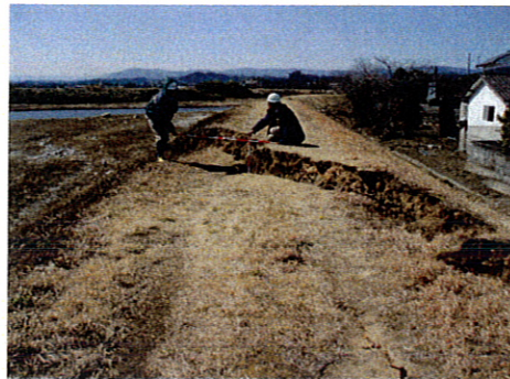
〔河川〕 堤防亀裂 仁井田川
