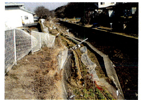
〔河川〕 護岸倒壊 湯長谷川
