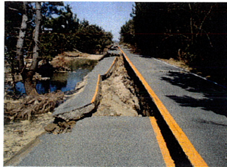
〔道路〕 路面崩落 豊間四倉線
