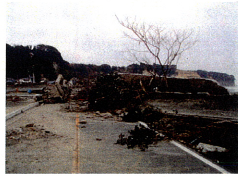
〔海岸〕 堤防倒壊 勿来海岸(背後は泉岩間植田線)
