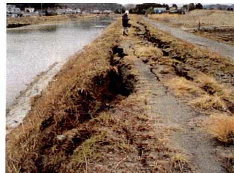
〔河川〕 堤防亀裂・崩落 滑津川
