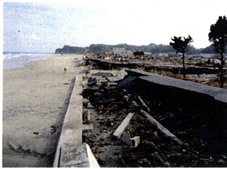
〔海岸〕 堤防倒壊 薄磯海岸(背後は豊間四倉線)
