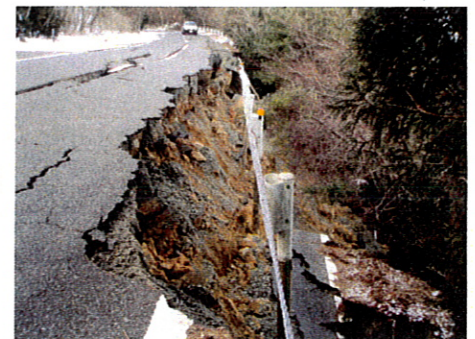
〔道路〕 路肩崩落 湯ノ岳別所線
