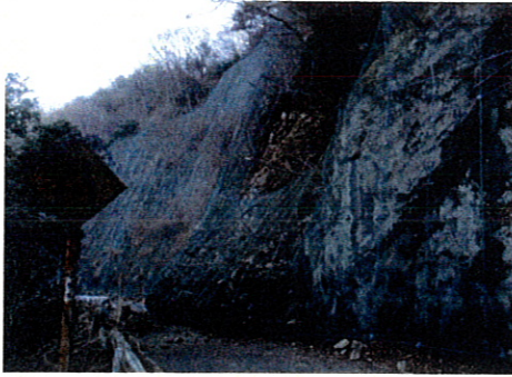
〔道路〕 法面崩落 小野四倉線
