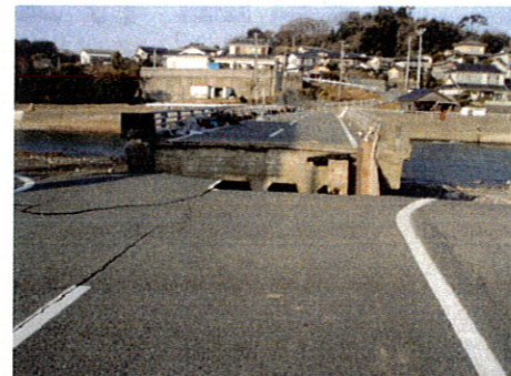
〔道路〕 橋台背面崩落 久之浜停車場線
