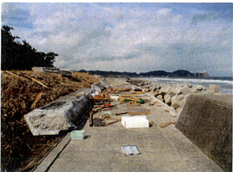
〔海岸〕 堤防倒壊 平海岸(豊間海岸)
